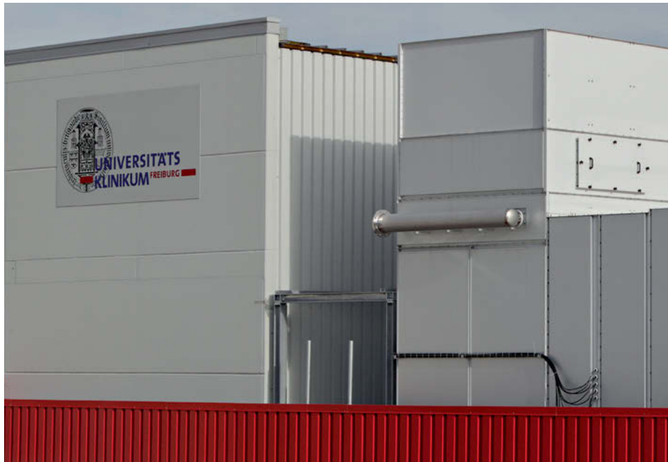
4 x DTC ecoTec / Universitätsklinikum Freiburg 4 x DTC ecoTec / Universitätsklinikum Freiburg – university hospital
