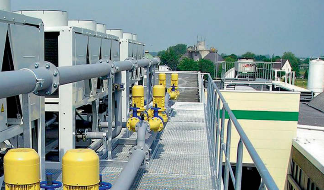
Quelle: HOFFMANN Maschinen- und Apparatebau GmbH, Kaltwassersystem Source: HOFFMANN Maschinen- und Apparatebau GmbH, cold-water system
