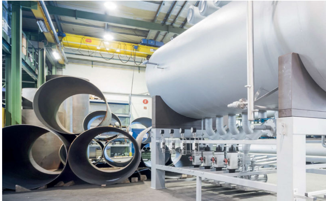
HAM Abscheiderbaugruppe (ø2,2 m x 7 m) mit 4x HRP8050 Kältemittelpumpen, HDB3 Ölsammelbehälter in Edelstahl und Differenzdruckverrohrung mit Manometern HAM separator unit (ø2,2m x 7m) incl. 4x HRP8050 refrigerant pumps, HDB3 stainless steel oil drain vessel and differential pressure gauges
